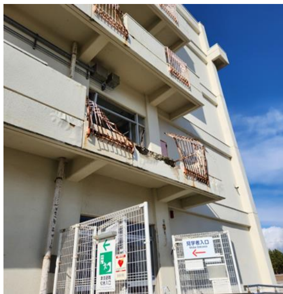
圖 12 被海嘯沖壞的護欄
