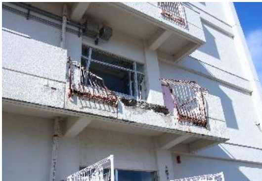
圖十五、荒濱小學校被海水沖擊而損壞的護欄
